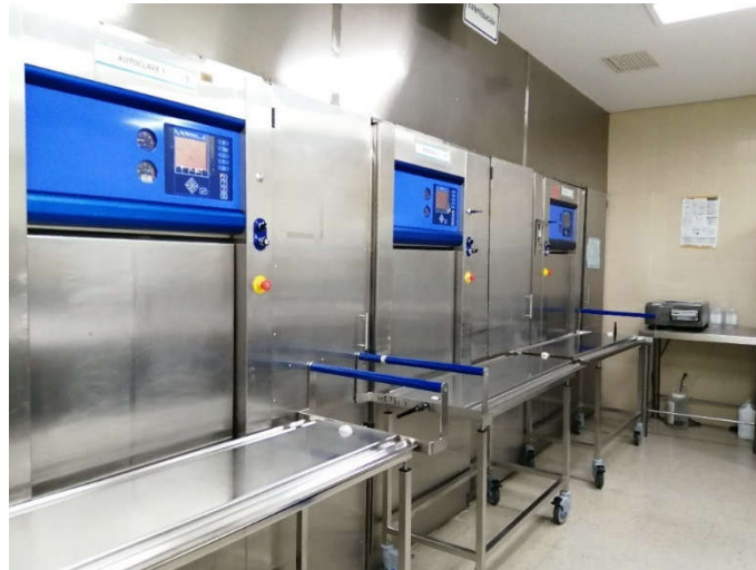
Figura 1. Autoclaves de calor húmedo del Departamento de Esterilización del CEMENAV.
